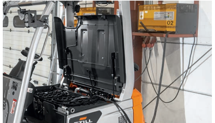
Kompakt STILL şarj istasyonu sayesinde merkezi olmayan akü şarjı da mümkündür
